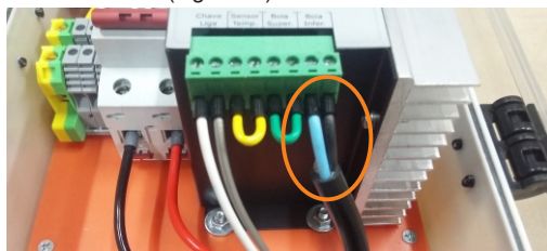
Figura 13: Funcionamento com automático de nível inferior (boia elétrica)
