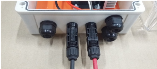
Figura 6: Conexões dos cabos dos módulos fotovoltaicos ao quadro com inversor de frequência FAMAC SOLAR.
